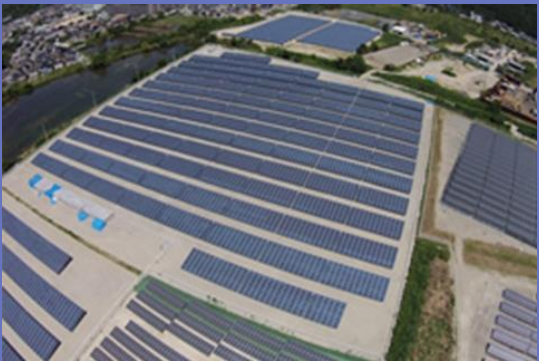
当社施工：姫路市太陽光発電施設
