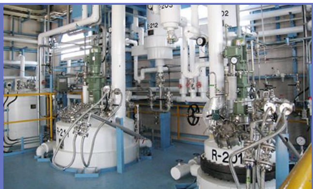
生産設備：SUS反応器（西工場）
