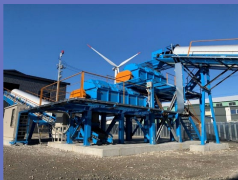
石狩FAリサイクルプラント 当社初となる木質灰 リサイクルプラント
