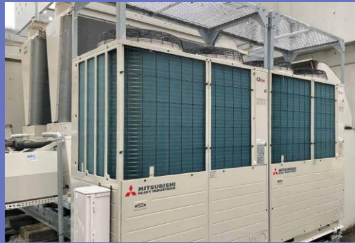
熱源設備 (業務用ヒートポンプ給湯機/ デマンド回避型ハイブリッド 給湯システム)
