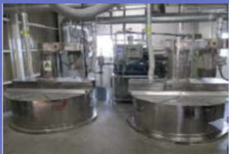
工場内の設備
