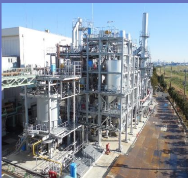
当社納入汚泥焼却炉設備全景（某下水処理場）
