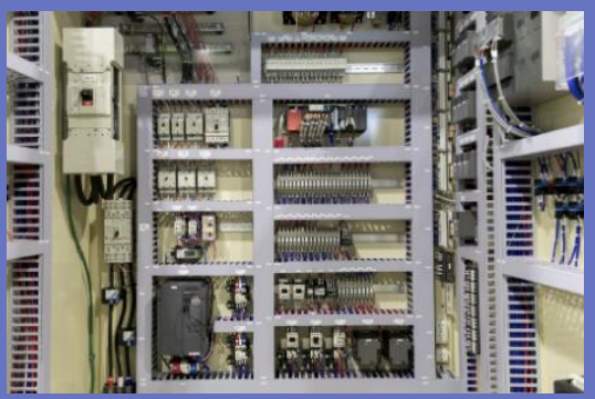
主力商品 制御盤
