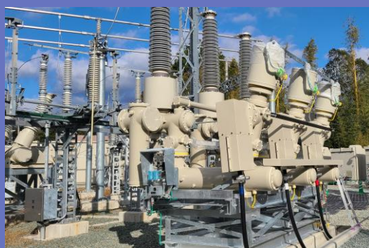
熊本県某所 太陽光発電設備 110kV 受変電設備 (設計、施工管理、検査点検)
