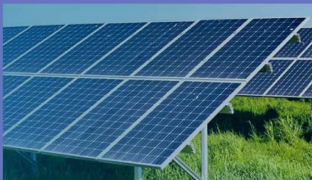
太陽光発電所
