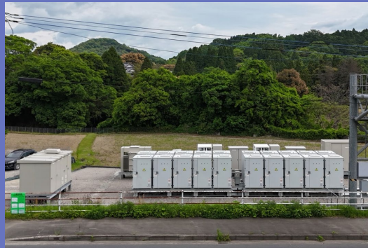
自社開発の高圧系統用蓄電所
